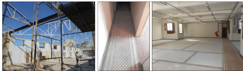
Figura 07: A) Estruturas metálicas da cobertura no anexo. (Fonte: Daniel Moratori, 2014) B) Ladrilho Hidráulico do 2º pav. (Fonte: Daniel Moratori, 2014) C) Pavimento após demolição das paredes marcadas em preto na paginação do piso (Fonte: Arquitetônica, 2017)
