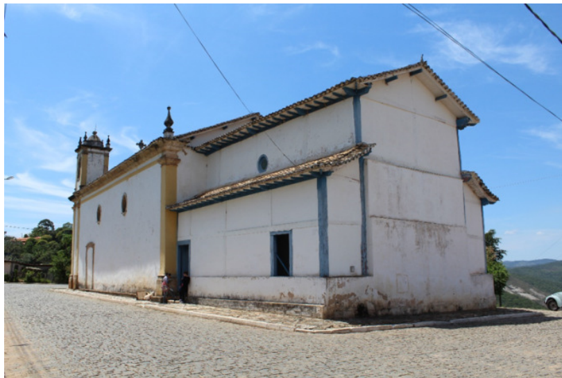
Figura 4 - Fachada lateral esquerda vista dos fundos. Detalhe da marcação da estrutura em madeira na capela primitiva. Foto: Fernanda Silva, 2014.
